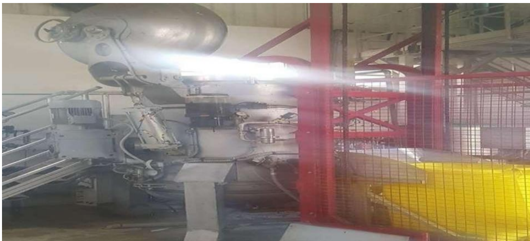
Figure 26: Machine de l'incinérateur.
