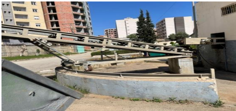
Figure 36 : L'évacuateur de boue déshydratée.
