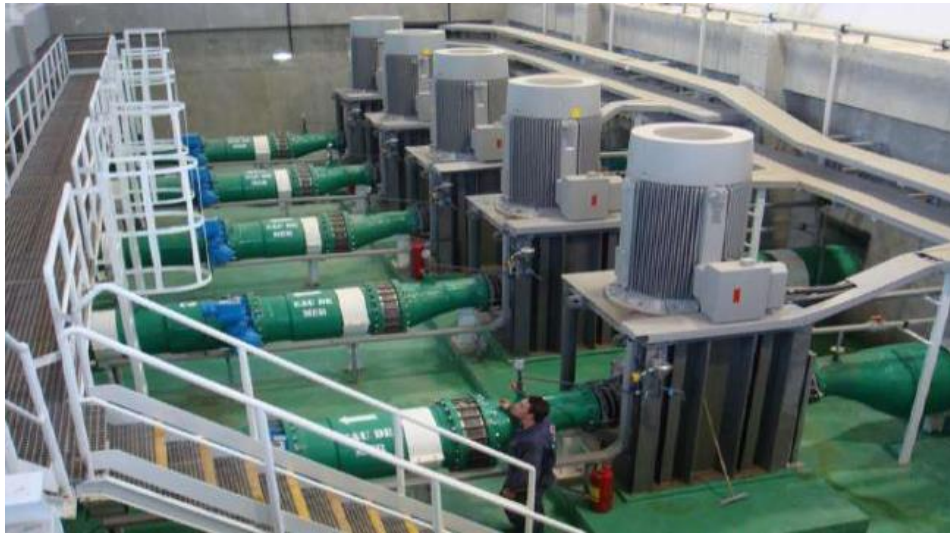
Figure 74: Station de pompage de l'eau de mer.
