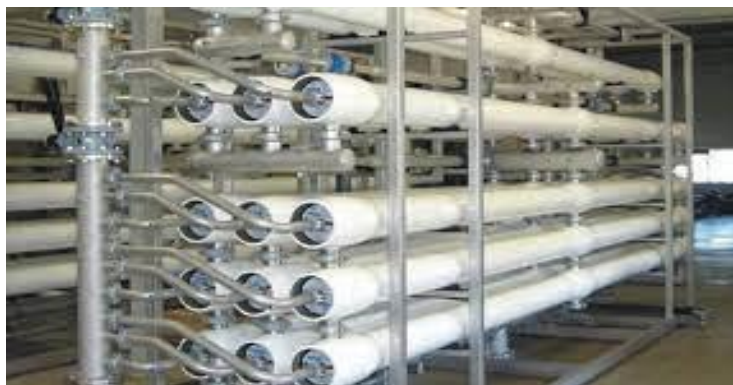
Figure 78: Châssis d'osmose inverse.
