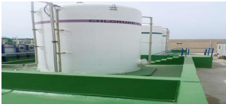
Figure 75 : Réservoirs des produits chimiques.
