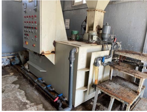
Figure 34 : Station de préparation des Polymère.
