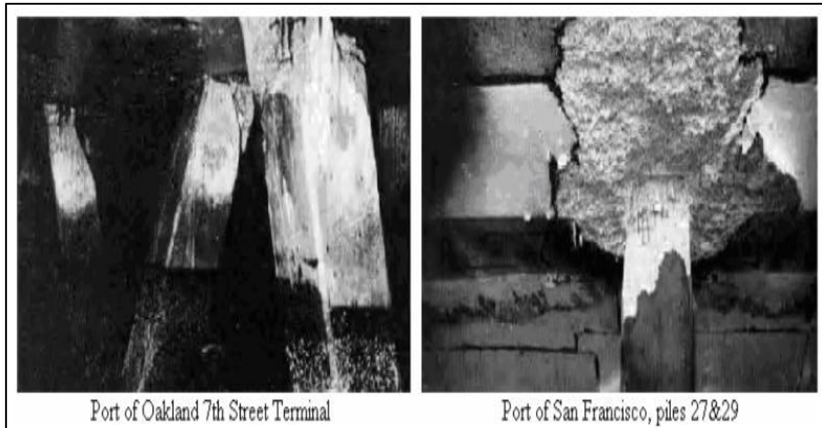
Figure III.1. Dommages de pieux inclinés au niveau de la connexion avec leur chevêtre (Séisme de Loma Prieta 1989, SEAOC 1991)
