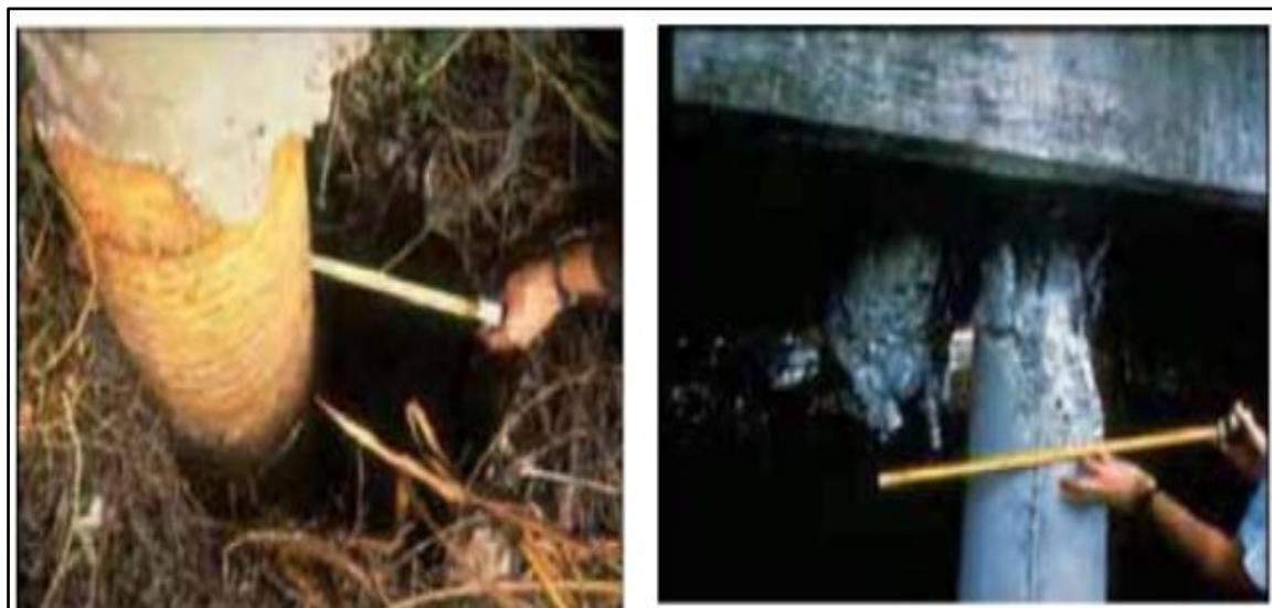
Figure III.2. Effondrement du pont de Struve Slough près de Wastonville et les dommages subis par ses fondations, (Séisme de Loma Prieta 1989)
