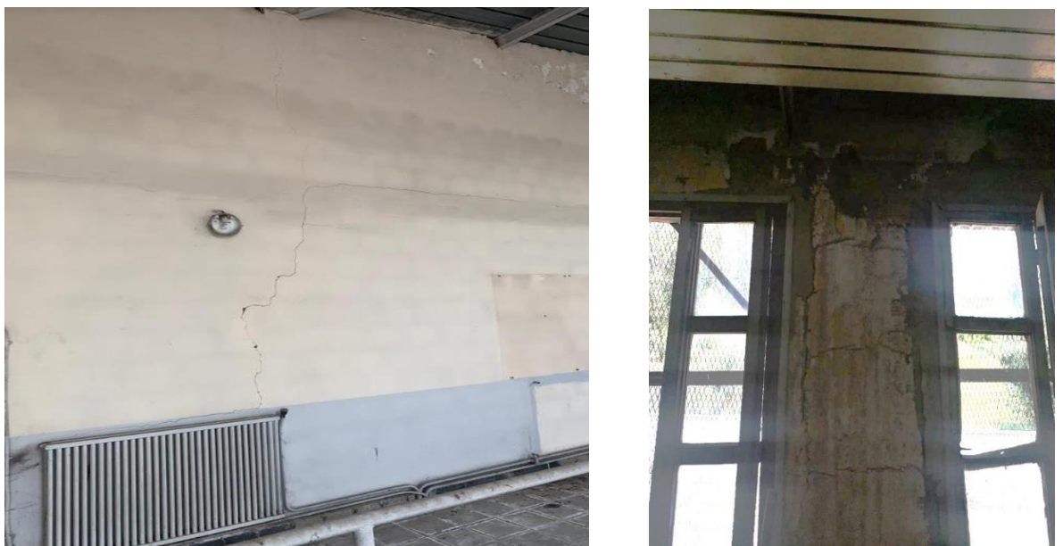
Figure IV.14. Fissuration et dégradation des murs intérieurs.
