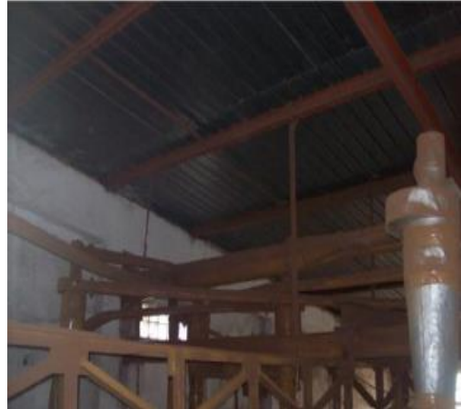
Figure II.5.B. Corrosion des profils des poutres de l'usine de liège
