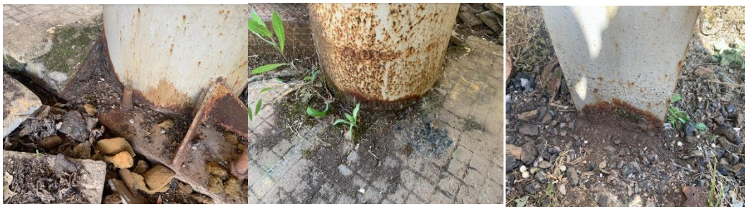
Figure IV.8.d. Poteaux exposés à l'environnement (contact direct avec le sol)
