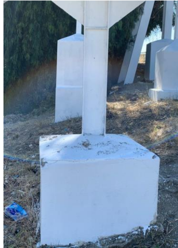
Figure IV.2. Présence des fissurations
