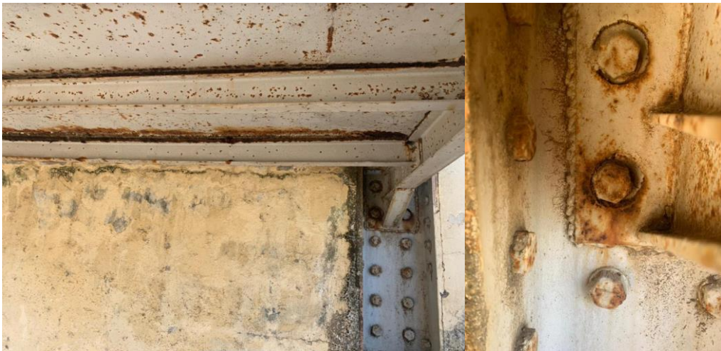
Figure IV.21. Assemblage mal fait (soudure, boulons)
