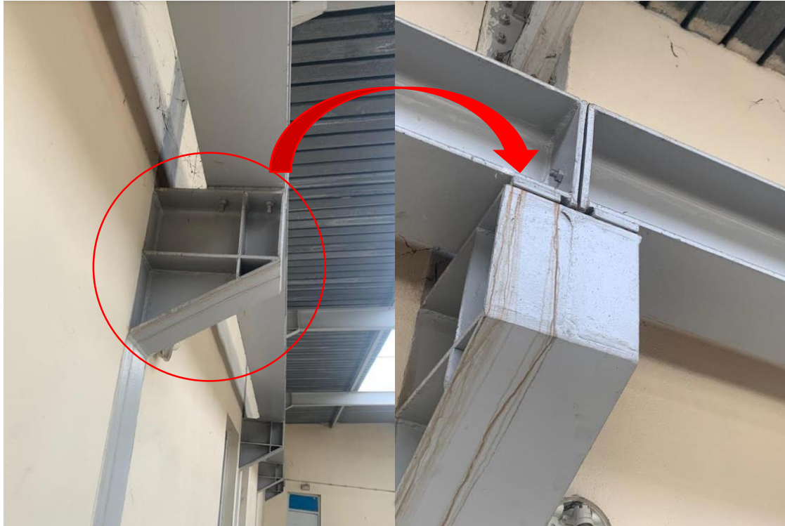
Figure IV.19. Infiltration des eaux
