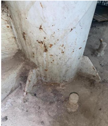
Figure IV.8.b. Présence de pièges à poussières
