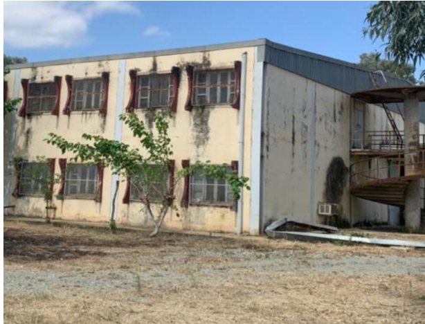
Figure IV.13. Présences de fissures et de moisissures sur les murs extérieurs.
