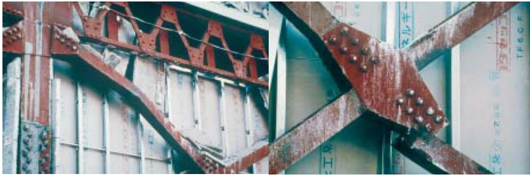
Figure II.7. Des barres diagonales à larges ailes ont flambé par rapport à leur axe faible et se sont rompues (Kobe, Japon, 1995) [14]
