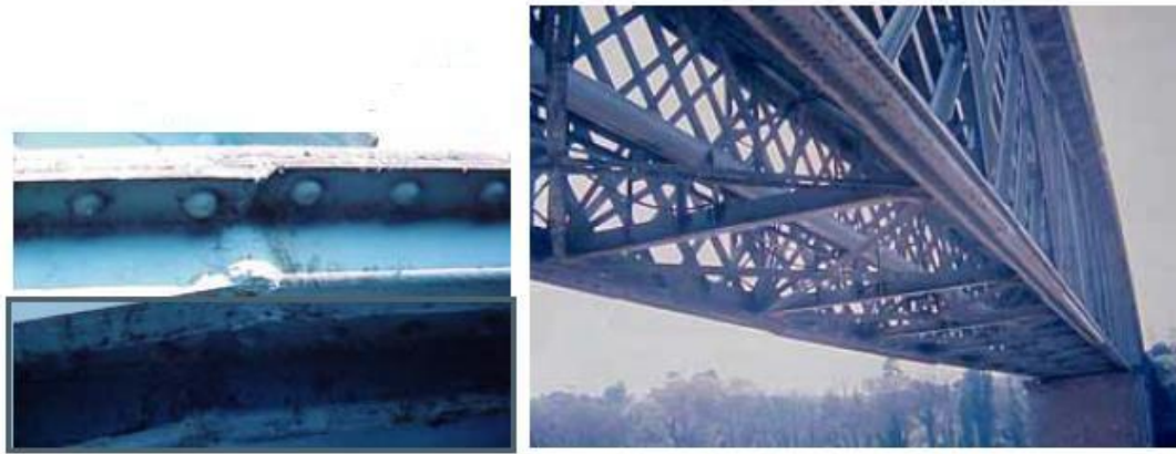
Figure III.10. Ajout de matière sous la membrure inférieure entre lignes de rivets (Pont de Douarnenez) [17]
