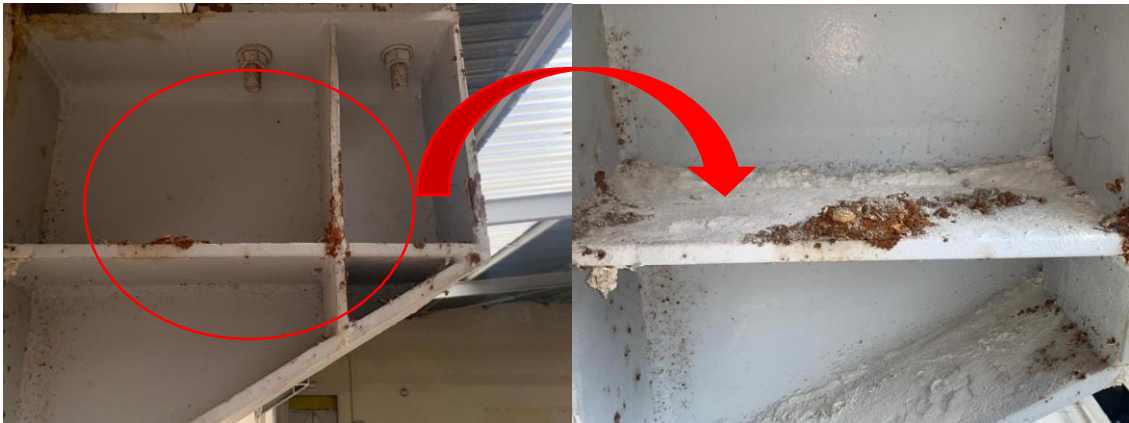
Figure IV.18. Présence de corrosion
