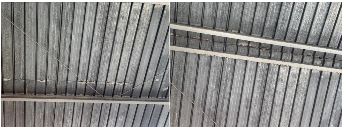
Figure IV.10. Présence légère de corrosion
