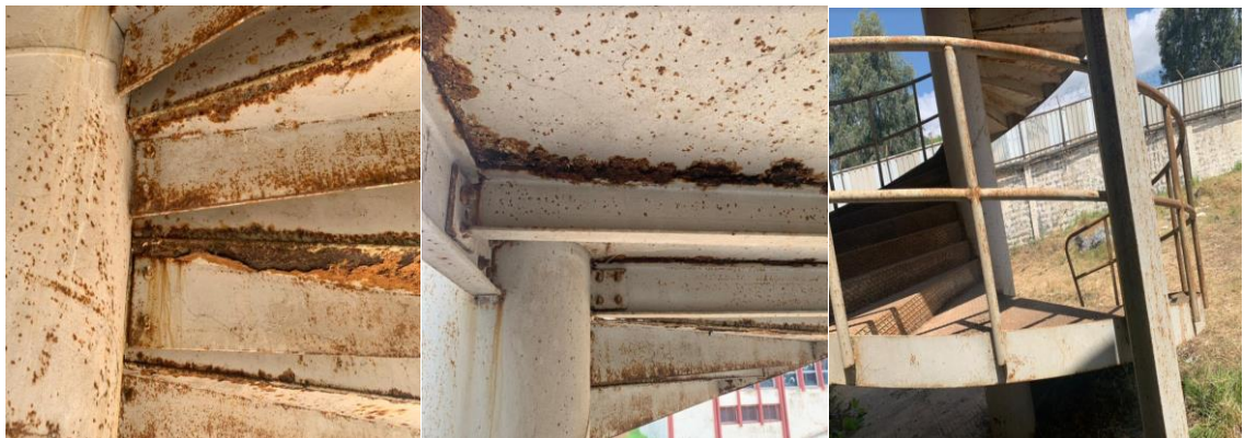
Figure IV.12. Présence de corrosion avancée.
