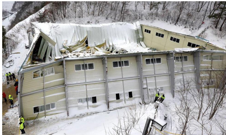
Figure II.3. Le toit s'est effondré sous le poids de la neige [18]
