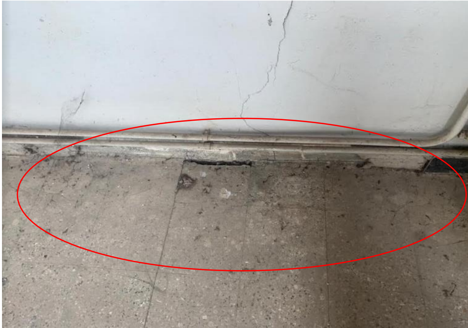
Figure IV.9. Détérioration au niveau du carrelage et décollement des plintes
