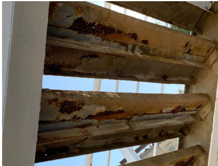
Figure IV.6. Présence importante de corrosion
