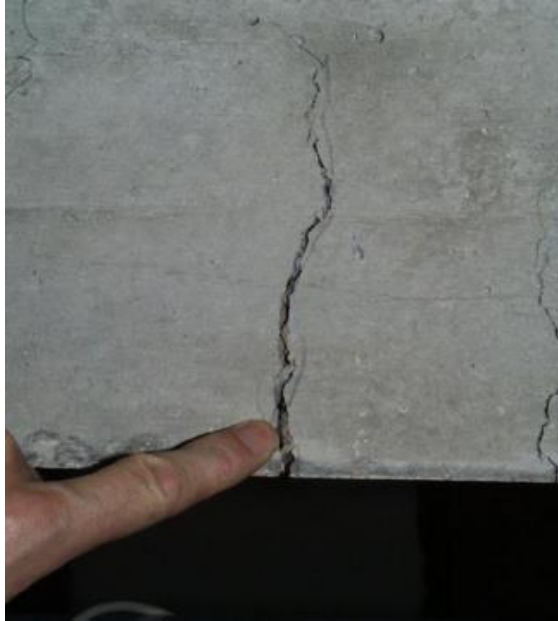
Figure II.24. Apparition des fissures causée par le décoffrage prématuré [22]
