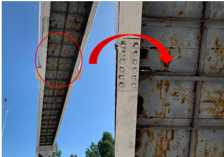
Figure IV.4. Présence de corrosion
