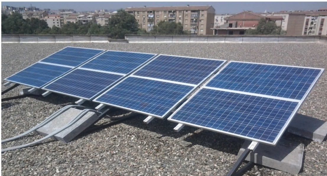
Figure IV.1 : Modules PV installés sur le toit du laboratoire LATAGE.
