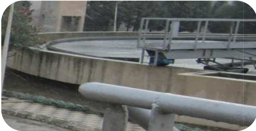
Figure 17: clarificateur (décanteur secondaire)
