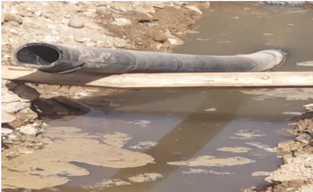
Figure 5. 1: la conduite utilisée.
