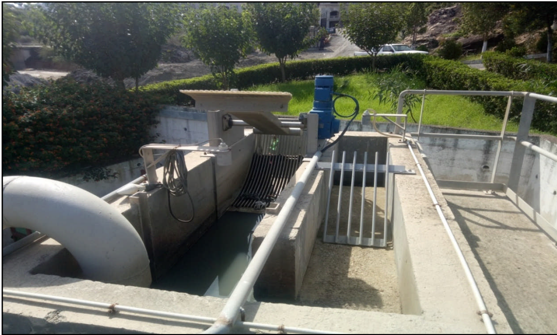
Figure 06 : Dégrilleur fin automatique.
