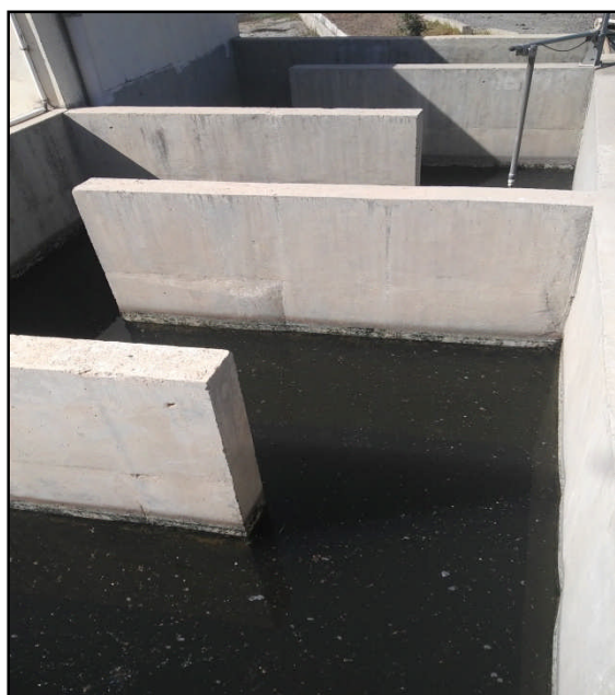
Figure13 : Bassin de désinfection.
