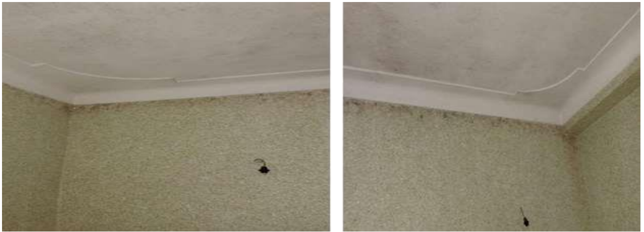
Figure1: Problème d'humidité sur les murs des constructions, photos prise par l'auteur lors d'état des lieux janvier 2022, Azeffoun, Tizi Ouzou source. Auteurs, 2022.
