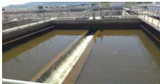
Figure 9. Bassins de filtration à sable
