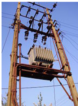
Figure I.7 : le transformateur de puissance
