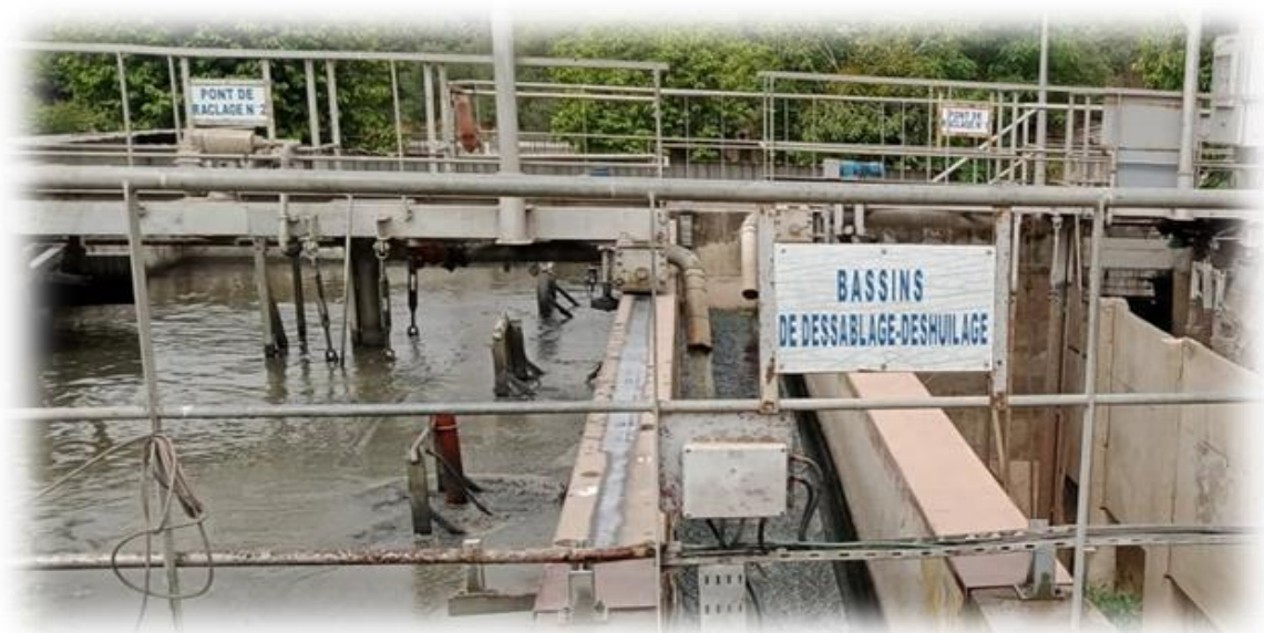
Figure 4. Bassins de Dessablage
