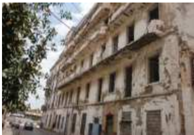
Figure I.35 : Vétusté des façades Source : auteurs
