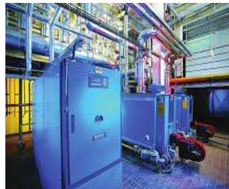
Figure IV.44: une installation de cogénération a petite échelle. Source : www.eubia.org/images/projects/old/RESTMAC_Cogeneration__french.pdf
