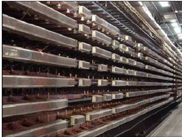
Figure : Le répartiteur général.
