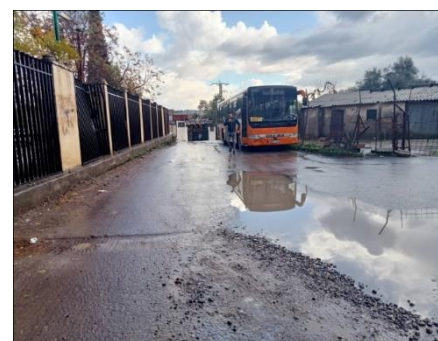
Figure 59: Photo de la dégradation de la voie Source: auteurs
