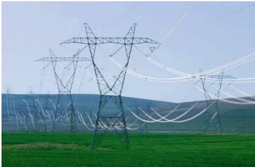
Figure 1-6: Photo de ligne de transport d'énergie électrique
