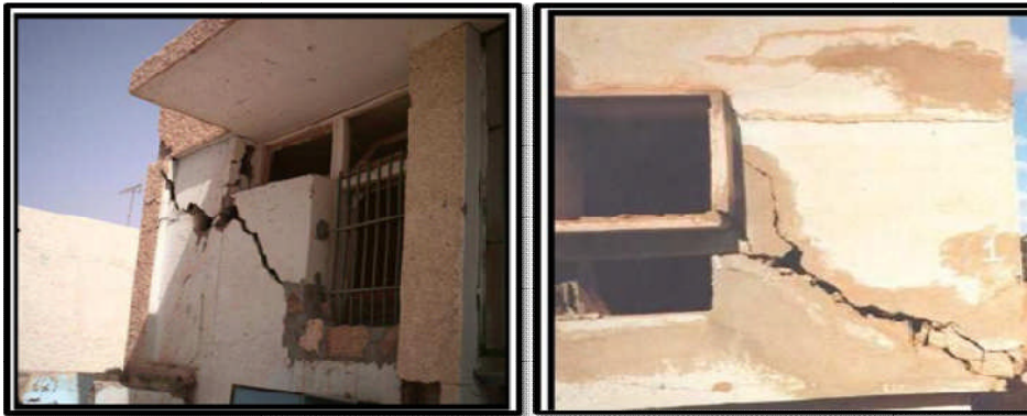
Figure III-14 : Fissure sur les murs et Fissures diagonales (DERRICHE Z et al.2002).
