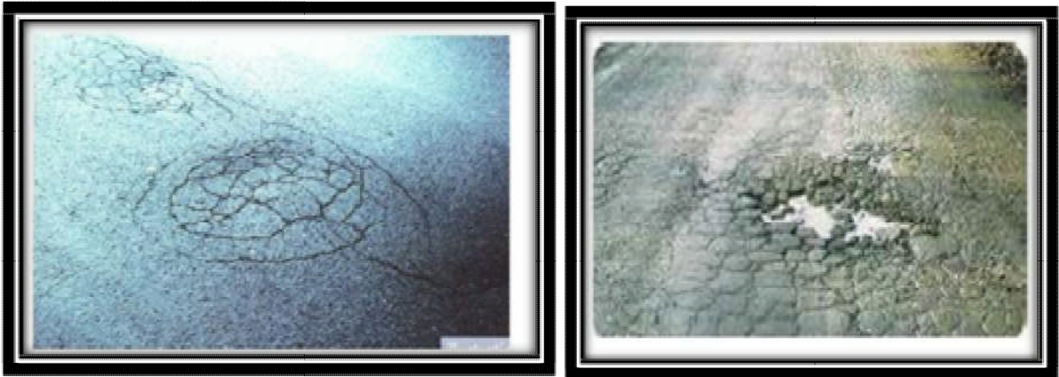
Figure III-17 : Dégradation des routes (FREEAH, 2006).
