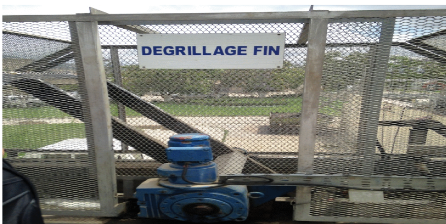
Figure 10 : Dégrilleur fin (ONA)
