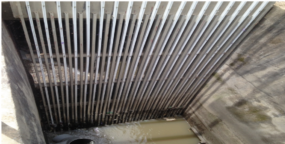
Figure 09 : Dégrilleur grossier (ONA).
