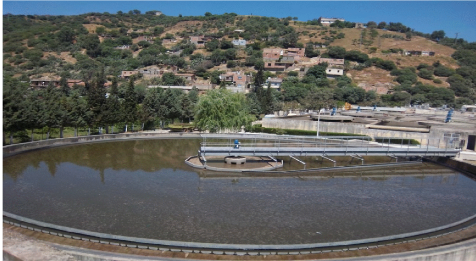
Figure 16 : bassin clarificateur (ONA)
