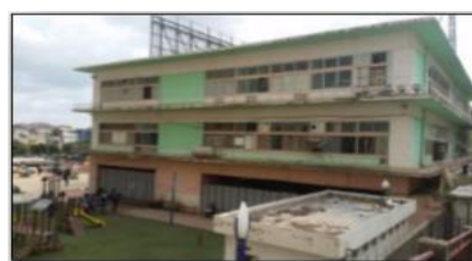
Fig.79. État de vitrage d'ouvertures Réf : Auteurs
