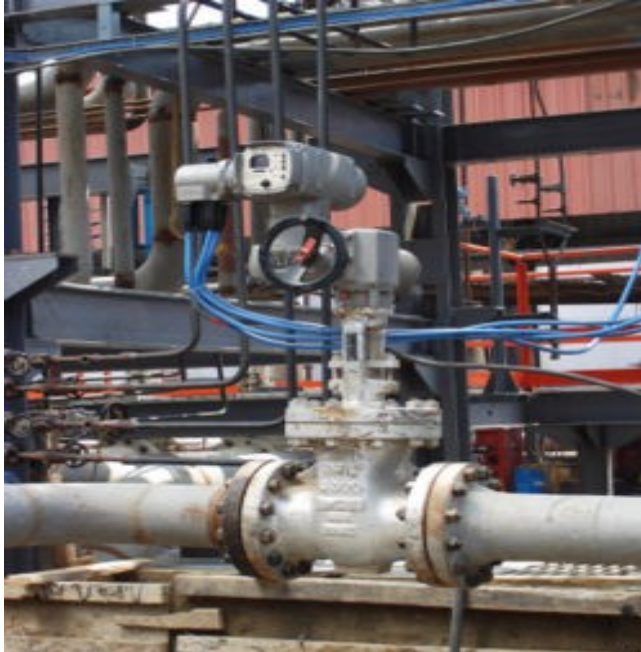
Figure 1.3. : Servomoteur électrique monté sur une vanne dans une centrale électrique
