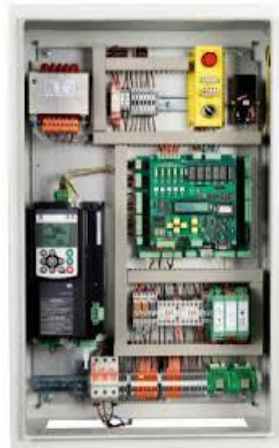
Figure 24 : Armoire de commande
