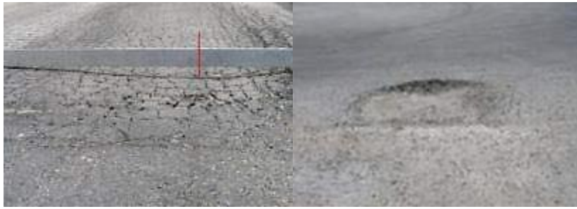
Figure III.12: Les dégâts causés par un faible compactage
