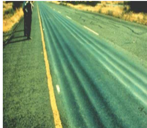
Figure III.11: Orniéage de la couche de roulement
