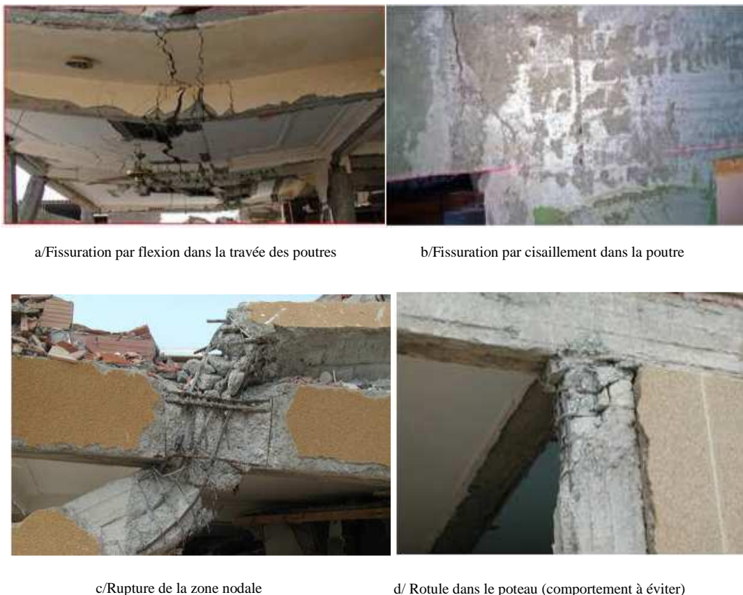
Figure I. 2: la rupture des éléments selon la nature des efforts lors du séisme de Boumerdes SEGHIR (2007).
