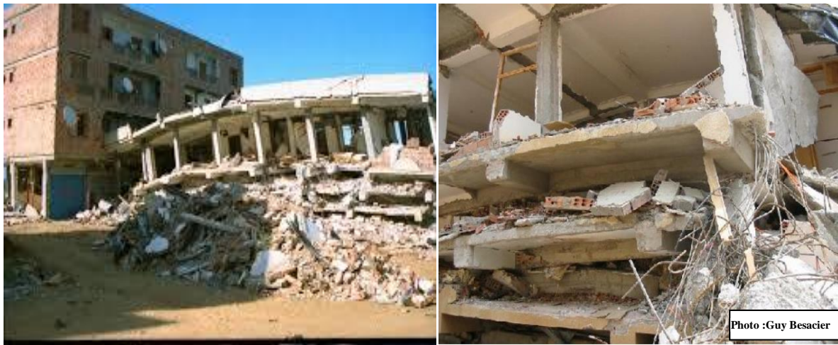
Figure I. 3: rupture de la structure par perte de stabilité
