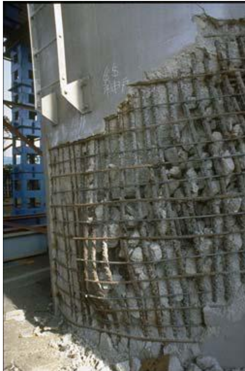
Figure I.15 : Les armatures ont évité la ruine à cette cheminé industrielle de 50 m [3]
