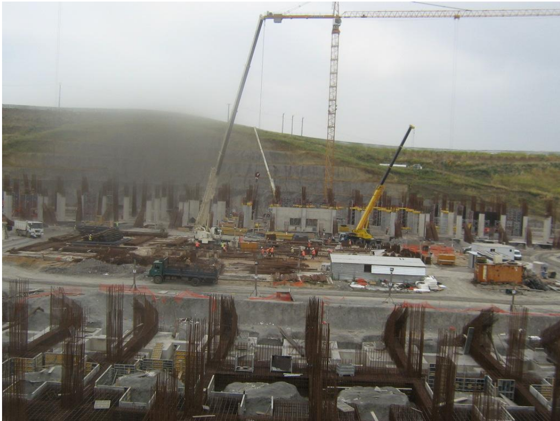
Figure.III.10 : Ampleur du ferrailage de la structure du nouveau stade de la JSK.
