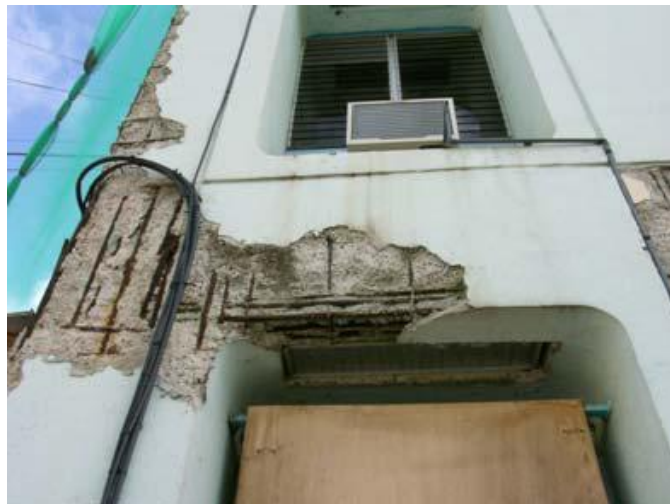
Figure I.17 : Corrosion d'aciers dont l'enrobage ne respecte pas les dispositions réglementaires en atmosphère corrosive. (photo d'une maison de la ville de Dellys).
