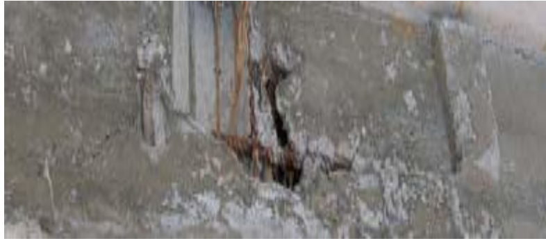
Figure I.16 : Béton non vibré : manque de matière et enrobage des aciers non réalisé. ( photo prise dans un chantier de la ville de Tizi Ouzou)
