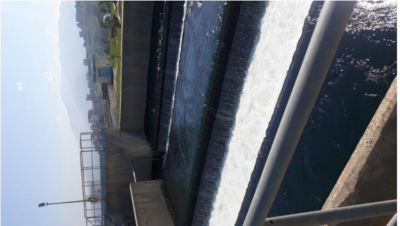
Figure IV.3 : Chambre d'arrivée de l'eau brute
