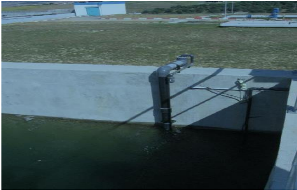
Figure IV.4. : Injection de Cl 2 en pré-chloration
