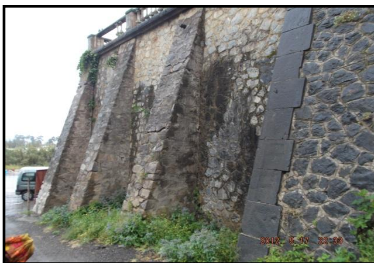
Figure 4. 20: Vue sur les contreforts qui soutiennent le mur de la cave. Source : auteur (prise en 2012).
