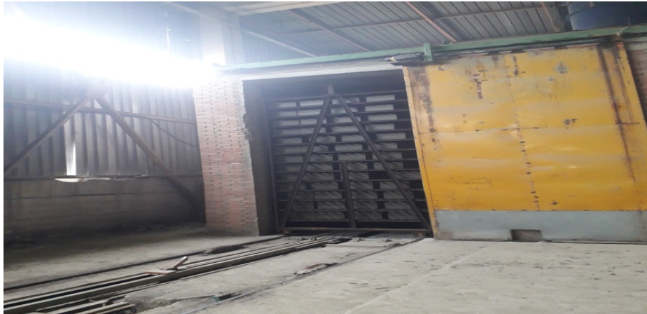
Fig.1.3 : image de la porte d'entrée de séchoir.
