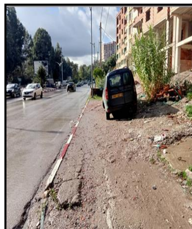
Figure 23: Trottoir dégradé. Source : Auteurs.
