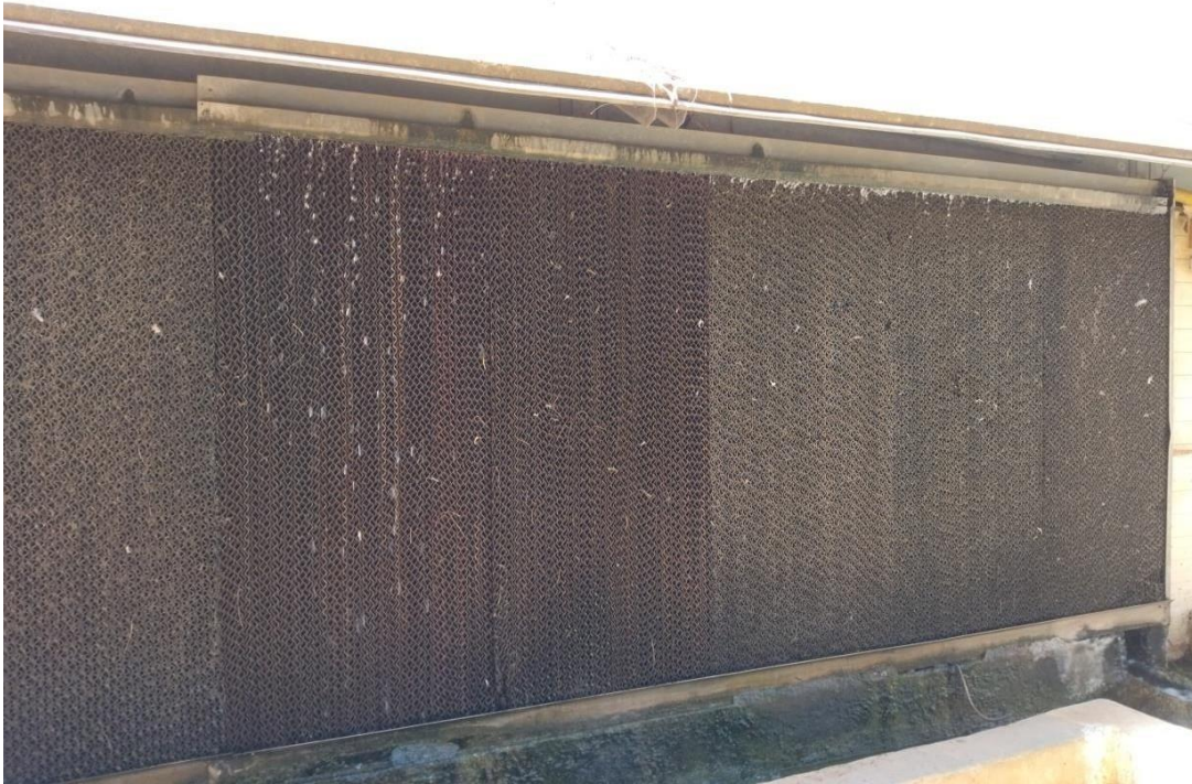
Figure 8: Humidificateurs de type pads-cooling
