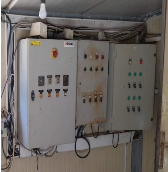
Figure 5: Les armoires de commande
