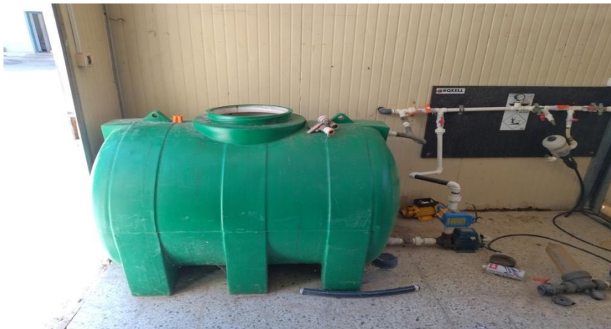
Figure 7: Le réservoir d'eau
