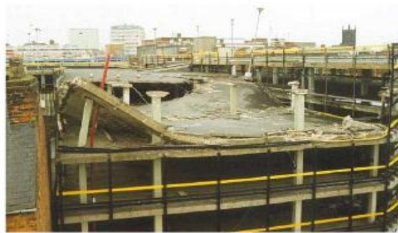
Figure I.13. Exemple d'un Cas d'effondrement de structures par poinçonnement: parking sur plusieurs étages en phase de construction. [24]
