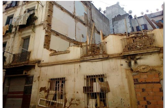
Figure 34 : bâtiment en état dégradé
