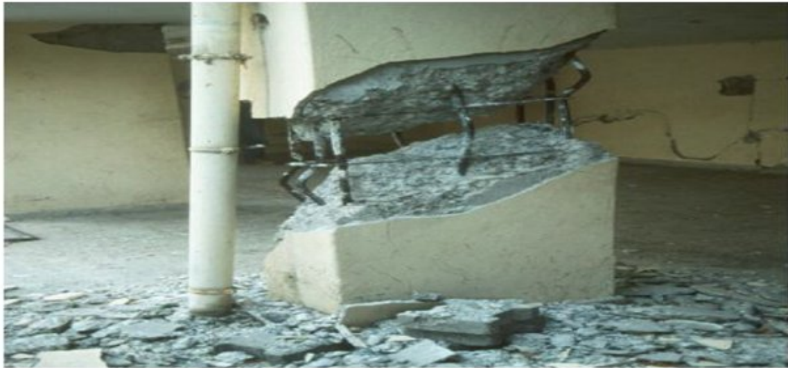
Fig. 2.10 : Rupture pour mauvaise qualité Rupture en compression du béton de mauvaise composition (dosage, agrégats) Et armatures non ductiles [21]. des matériaux (Ceyhan 1998)
