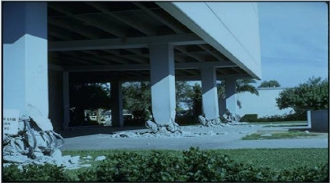
Fig. 2.8 : Rupture par formation des rotules plastiques aux pieds des poteaux [21].
