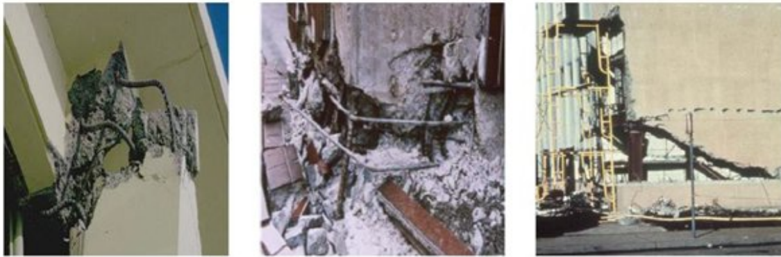
Fig. 2.11 : Rupture des zones critiques [23].
