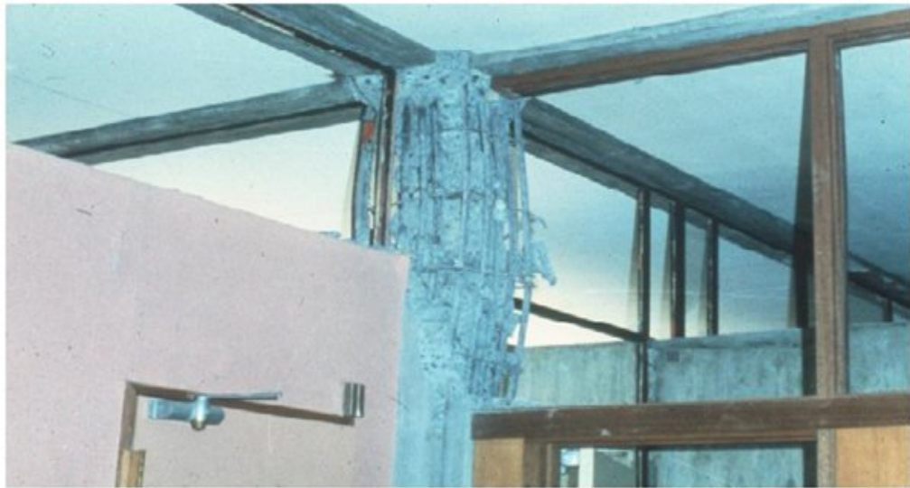
Fig. 2.15 : Rupture par écrasement du béton du au remplissage partiel [19].
