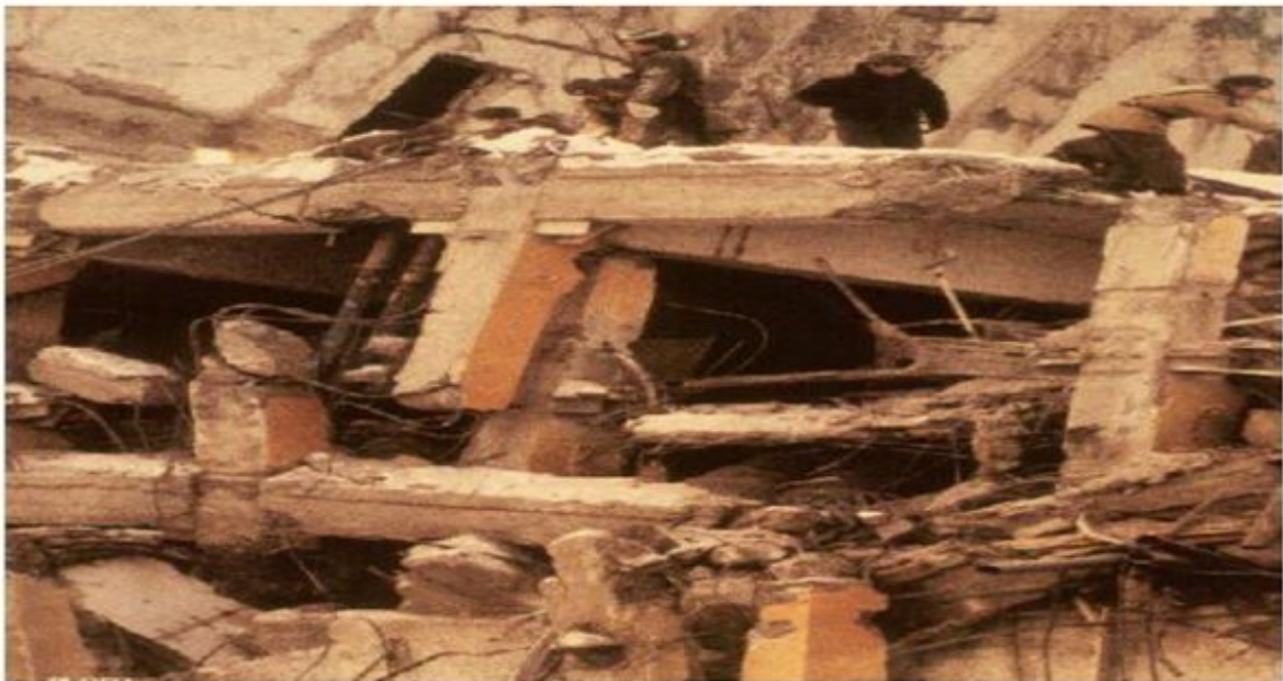
Fig. 2.9 : Rupture fragile de portique de béton armé (ARMENIE) conception incorrecte des armatures [22].
