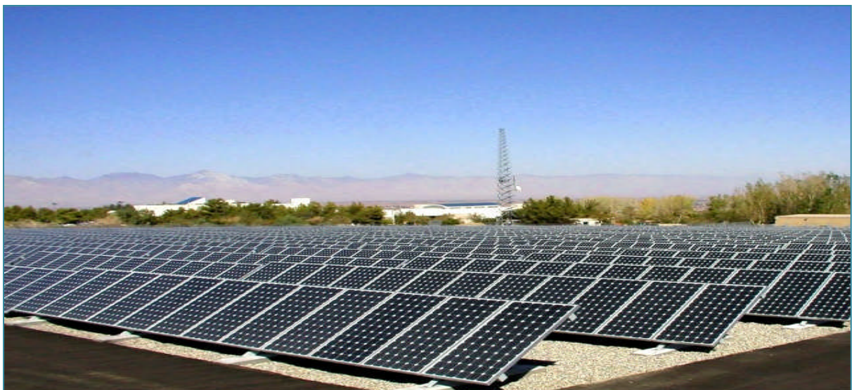
Figure I.11 : Centrale photovoltaïque de Ghardaïa(Algérie).
