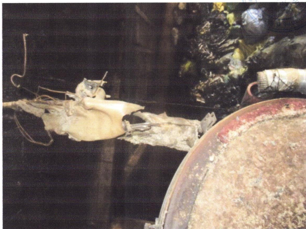
Photos : degré de calcination câblages et installations électriques
