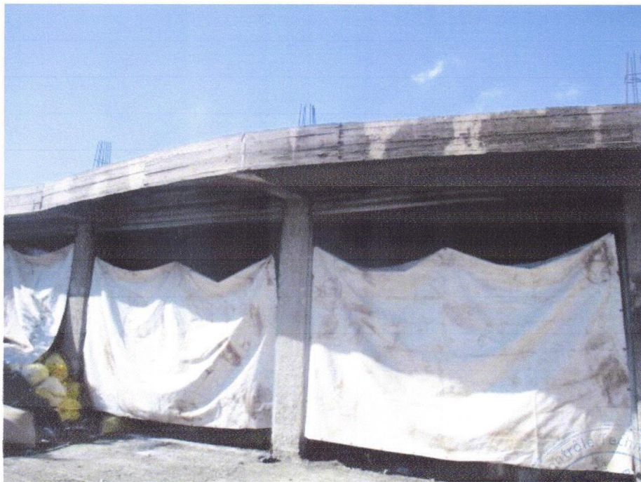
Photos : vue de l'extérieur du local incendié
