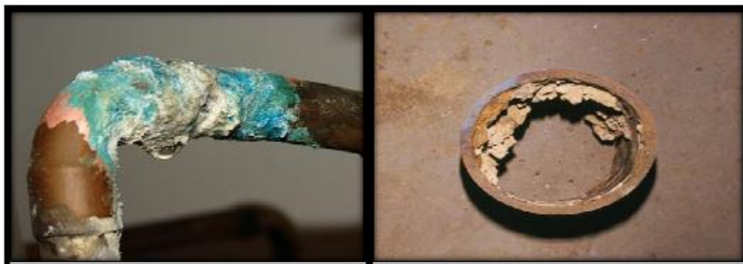
Figure VIII.14 : la corrosion dans les conduites
