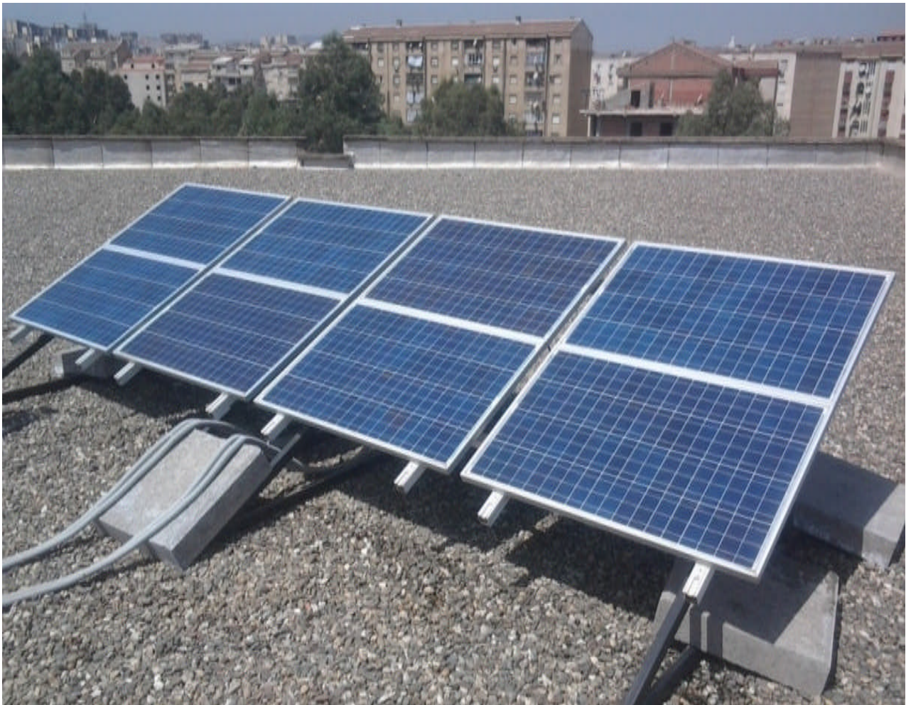
Fig.III.1 : Site photovoltaïque de laboratoire de recherche LATAGE-UMMTO
