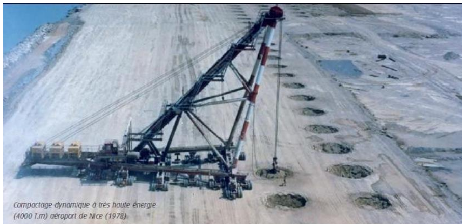
Figure II.1. Densification d'un terrain par compactage dynamique (cas réel de l'aéroport de Nice 1978, France).
