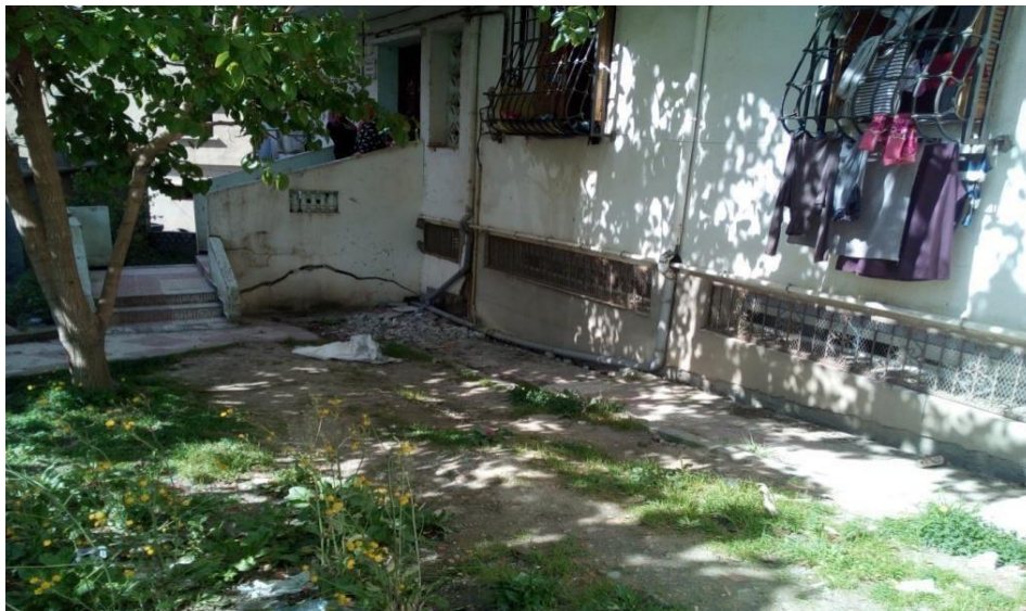
Figure I.12. Dégradations et fissurations des façades des bâtiments (Photo prise à Tizi-Ouzou).
