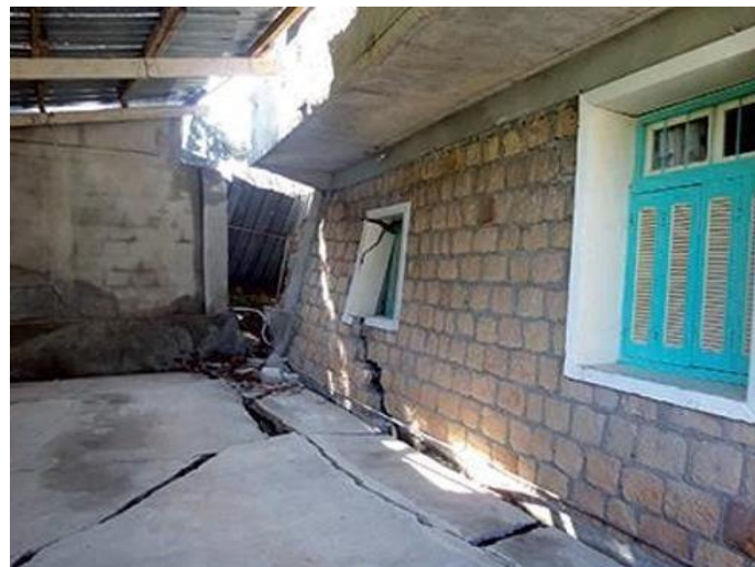
Figure I.16. Fissuration d'une maison lors d'un glissement de terrain (Azazga).
