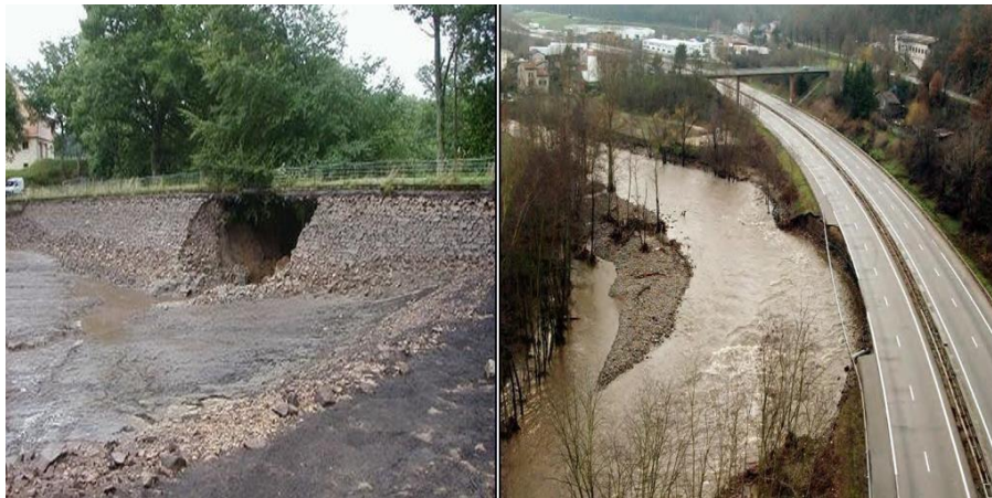
Figure I.19. Phénomène d'érosion dans les remblais routiers.
