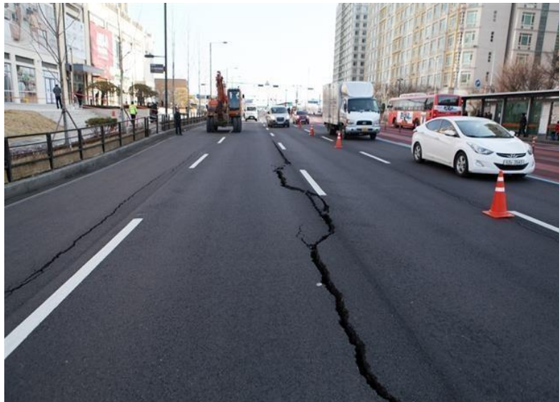
Figure I.13. Déformation d'une chaussée.
