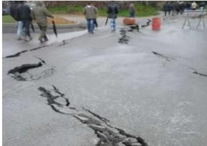
Figure I.15. Fissuration d'une route provoquée par un glissement de terrain(Azazga).
