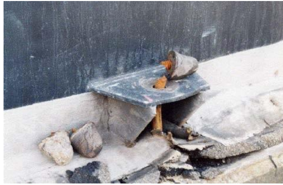
Figure 1-9 : Rupture d'une tige d'ancrage
