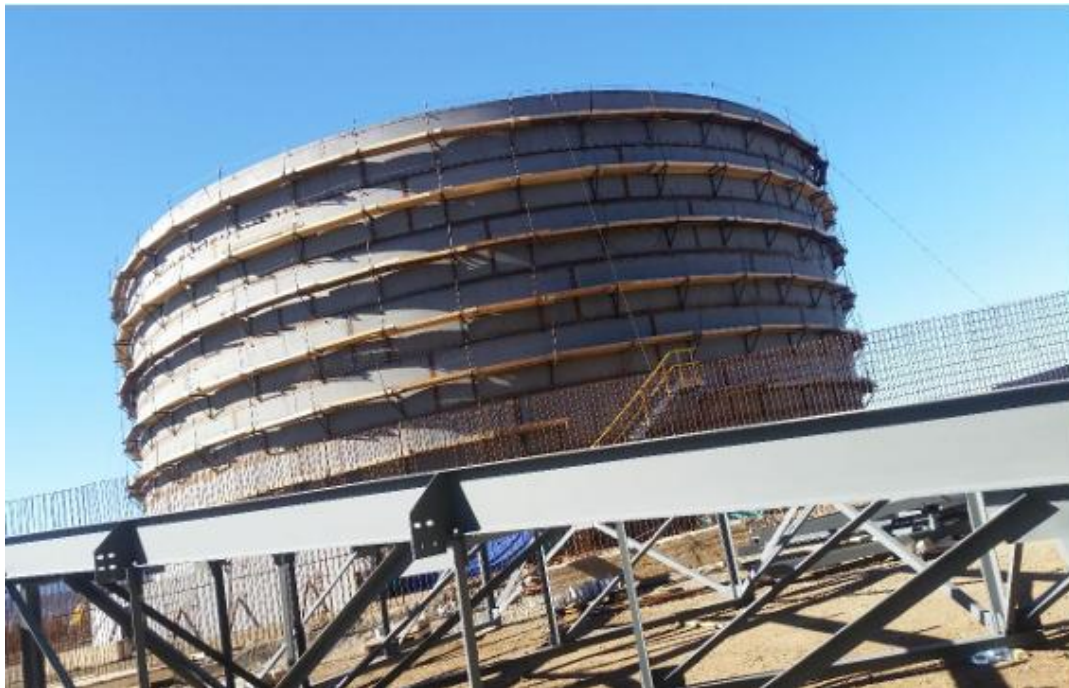
Figure 3-8 : Réservoir métallique posé au sol.
