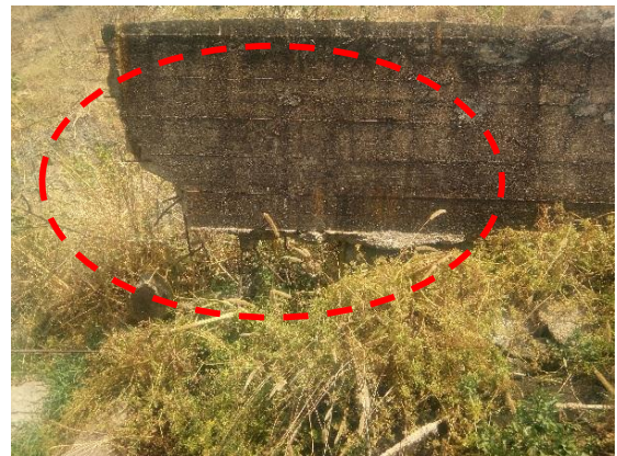
Figure 1.20: Détérioration des murs bajoyers du bassin de dissipation
