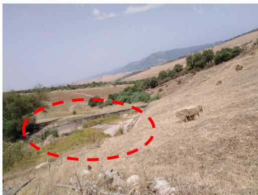
Figure 1.14 : Obturation de l'évacuateur de crue Par la végétation
