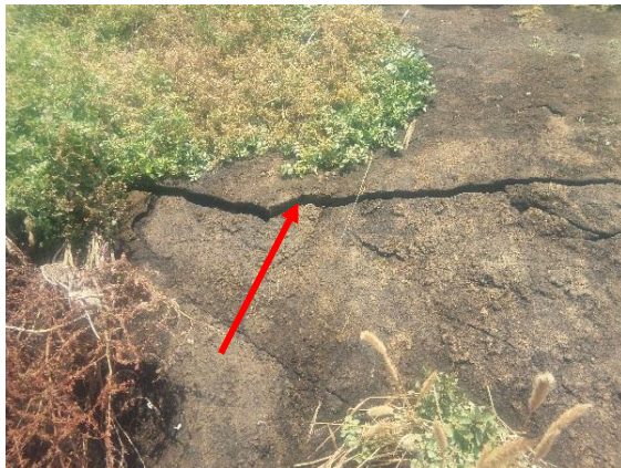
Figure 1.19 : Présence de fissures sur le bassin de dissipation
