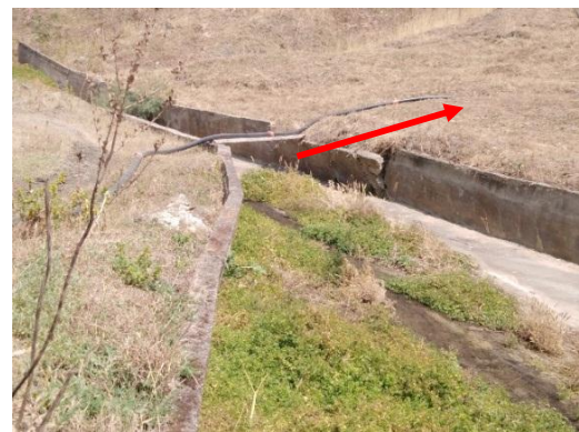
Figure 1.15 : Glissement de terrain sur les murs bajoyers de l'évacuateur
