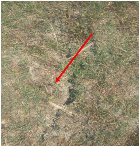
Figure 1.7 : Présence de fissures sur la crête
