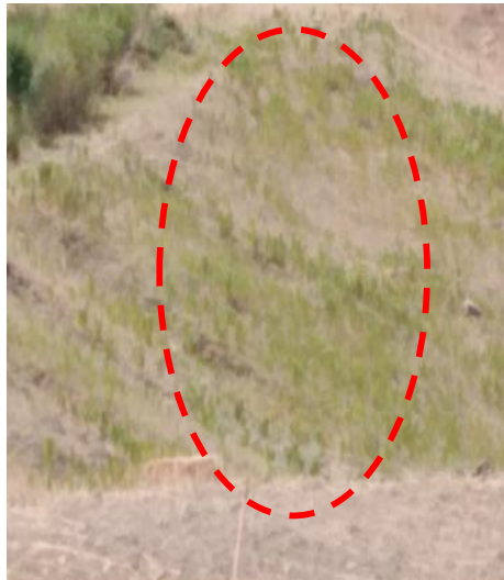
Figure 1.13: Glissement du talus aval de la retenue
