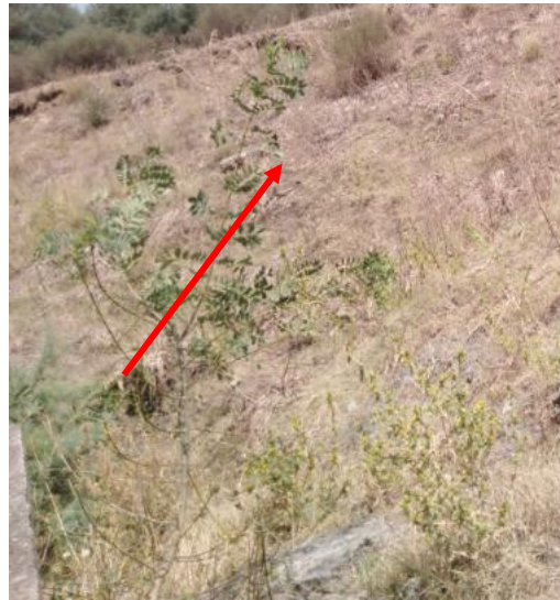
Figure 1.18: Glissement de terrain sur les bajoyers de coursier
