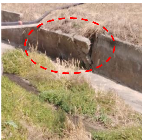
Figure 1.16 : Ruine des bajoyers au niveau de coursier
