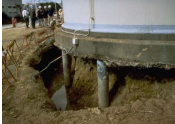
Figure II. 28 : Tassement dû à une liquéfaction, séisme de Kobé (Japon), 1995.
