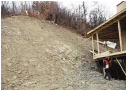
Déblai à la base du talus.
