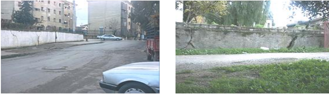
Figure II. 36 : Différents désordres enregistrés, (ancienne zone instable à Azazga).
