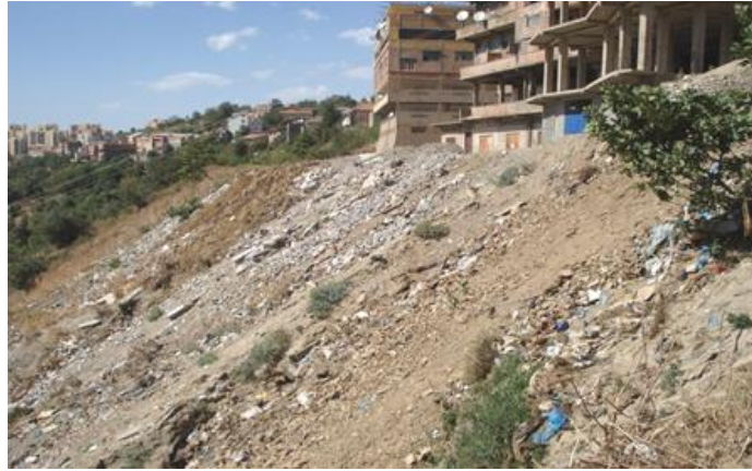
Figure II. 34 : Jets de remblais à la partie Ouest de la zone du marché.
