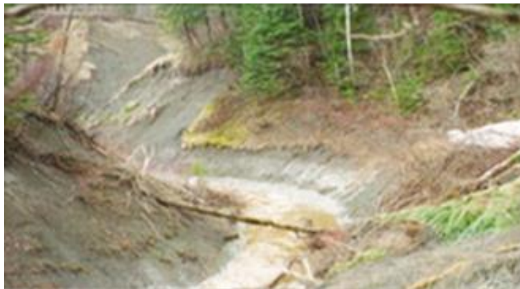
Figure II. 23 : Glissement dû au processus d'érosion.
