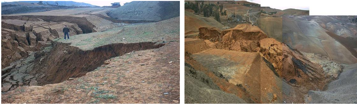
Figure II. 44 : Glissements de terrains, autoroute Est-Ouest, (contournement de Bouira).
