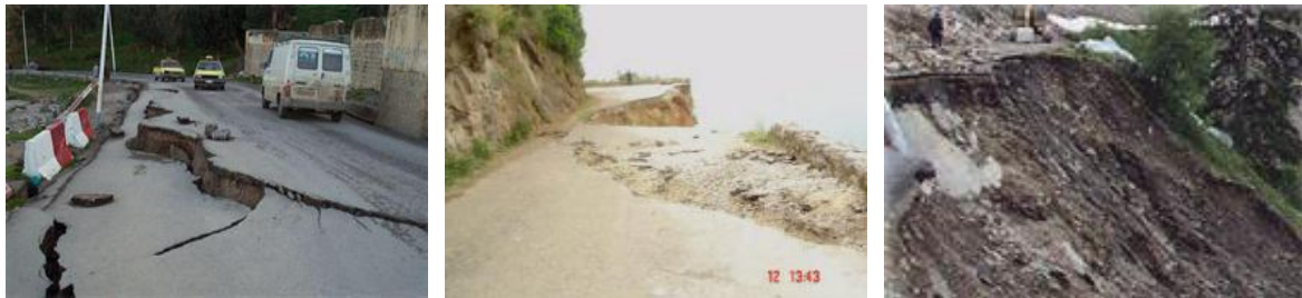
Figure II. 14 : Instabilités des talus (cas des routes).
