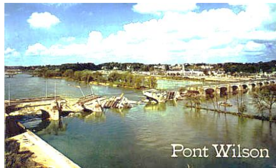
Figure II. 26 : Effondrement du pont Wilson en 1978 par affouillement (France).
