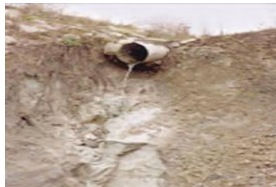
Concentration d'eau (érosion verticale).
