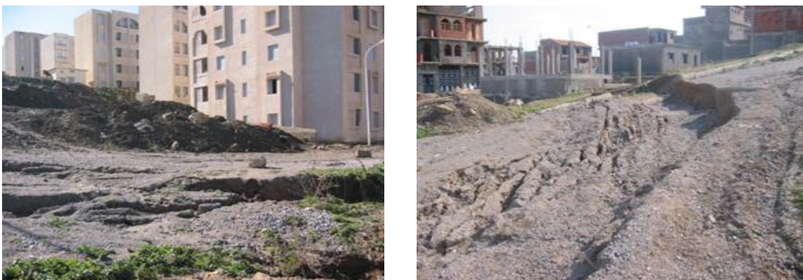
Figure II. 43 : Glissements de terrains, zone des 185 logements de l'OPGI, (Mila).
