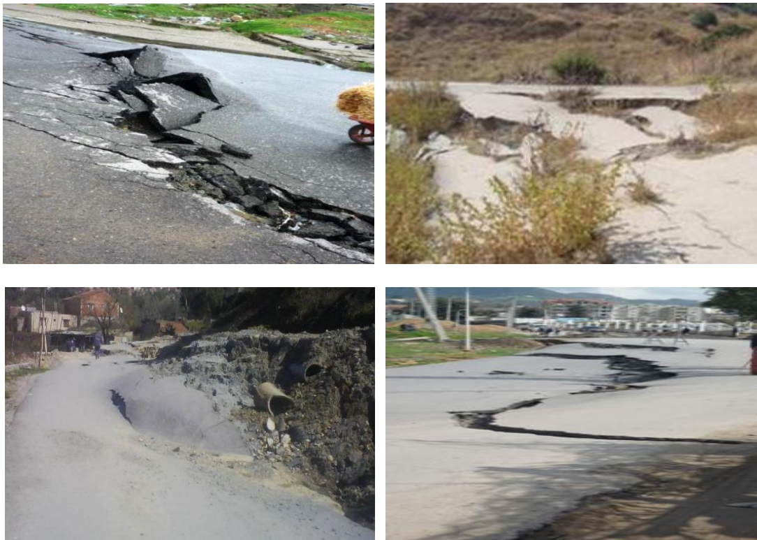
Figure II. 37 : Nouveaux désordres au niveau d'Azazga.
