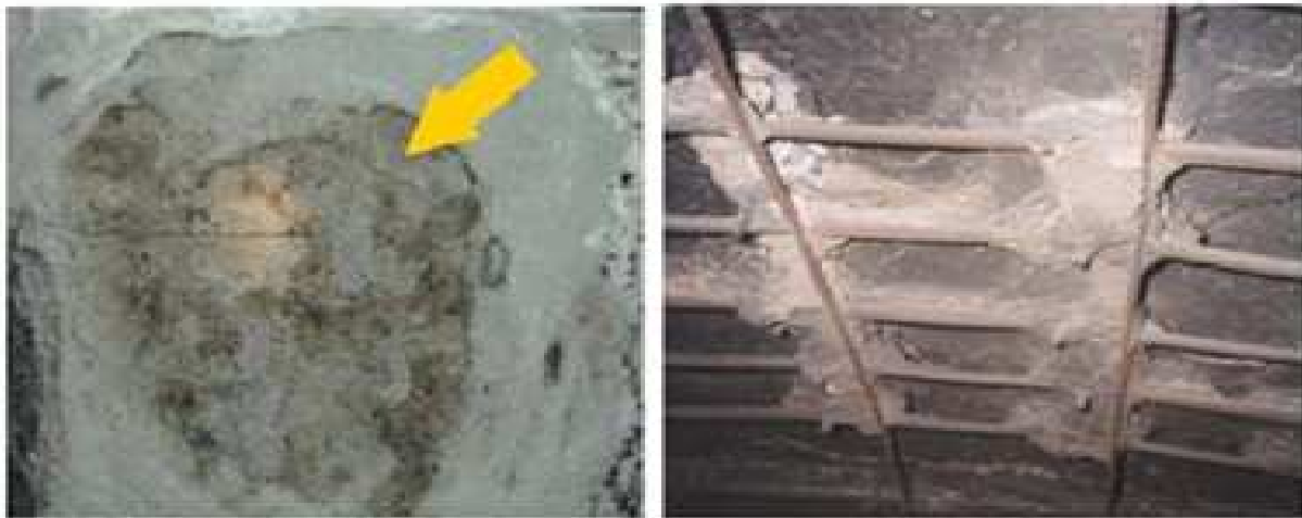
Figure 3-8 : l'écaillage lors de l'incendie du tunnel de MONT BLANC
