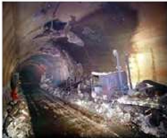
b) Mont Blanc : éclatement du béton.
