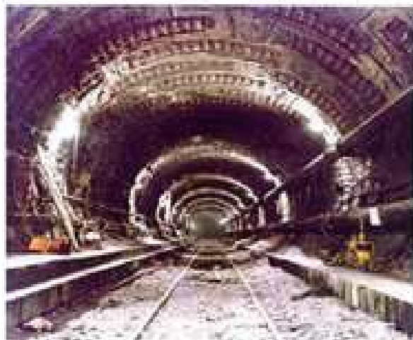
a) Tunnel sous la Manche : fort écaillage du béton.
