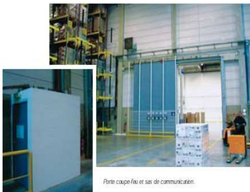
Figure 5-7 : Porte coupe feu dans hangar industrielle. [12]
