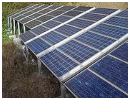
Figure I-4-a : centrale solaire photovoltaïque.
