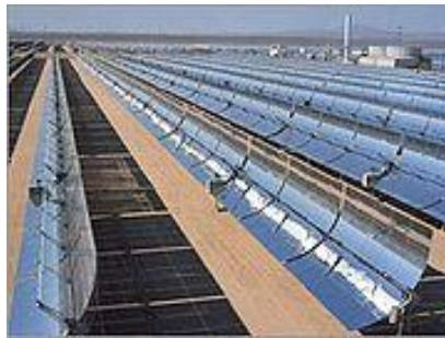
Figure I-4-b : centrale solaire thermique.
