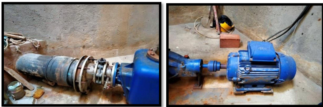
Figure III.3: La pompe d'aspiration de l'eau brute.
