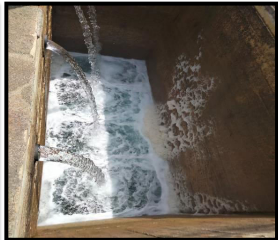
Figure III.9: Bassin d'eau décantée.
