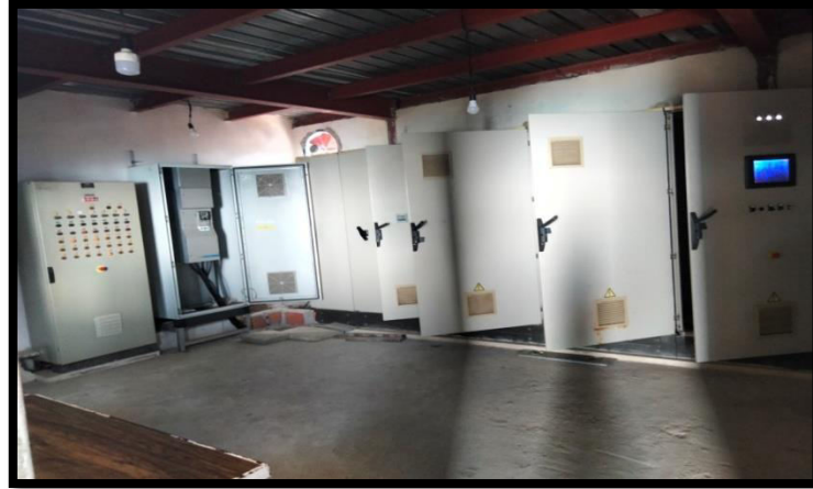
Figure III.21: Chambre d'armoires de commande automatiques.
