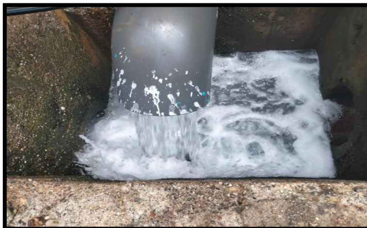
Figure III.20: La conduite de la saumure.
