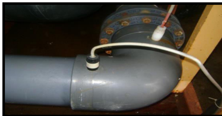
Figure III.12: Point d'injection de bisulfate de sodium.
