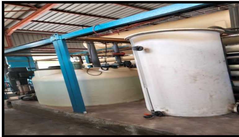
Figure III.19: Réservoir tampon de l'eau traitée.
