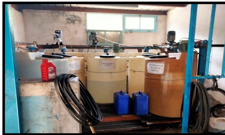
Figure III.22: Chambre de stockage chimique.
