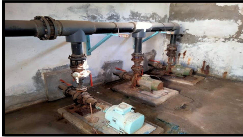
Figure III.10: L'installation des pompes d'apport.
