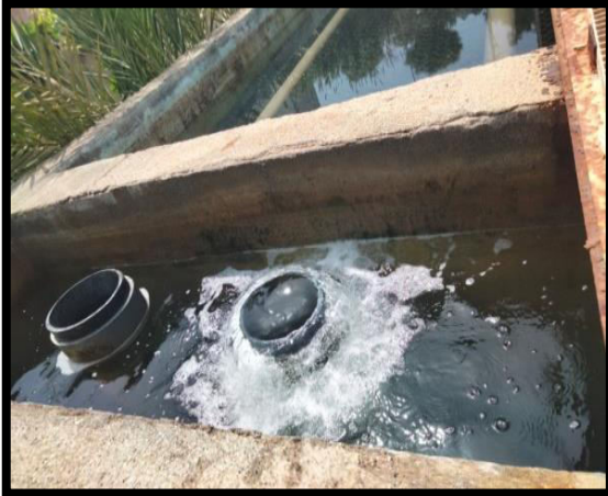
Figure III.6: Conduite d'eau brute.
