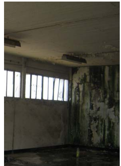
Photo 4.58. Salissure due aux infiltrations. (Source : l'auteur).
