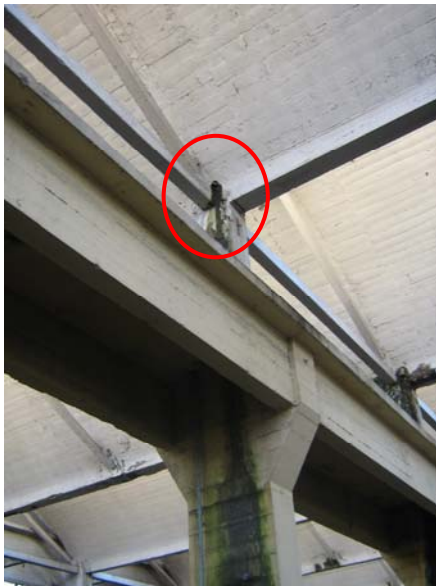
Photo 4.48. Dégradation des descentes d'eaux pluviales. (Source : l'auteur).
