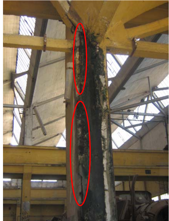
Photo 4.50. Armatures corrodées des poteaux. (Source : l'auteur).
