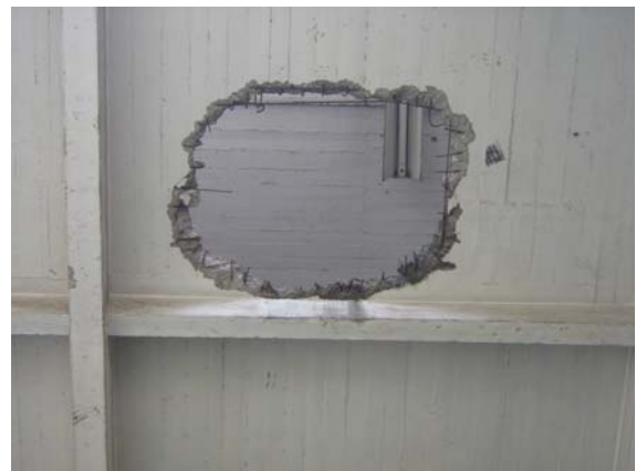
Photo 4.43. Dégradation du plancher du bloc C. (Source : l'auteur).
