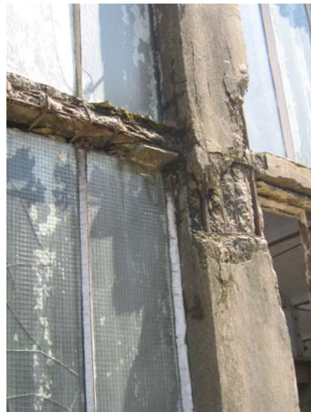
Photo 4.55. Corrosion des armatures des parements de façade. (Source : l'auteur).
