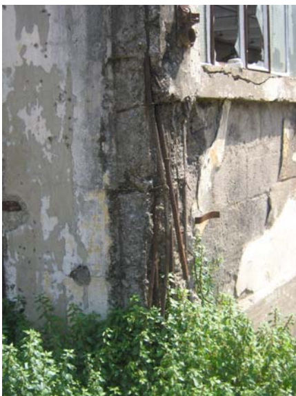
Photo 4.54. Corrosion d'armatures d'un poteau de rive. (Source : l'auteur).
