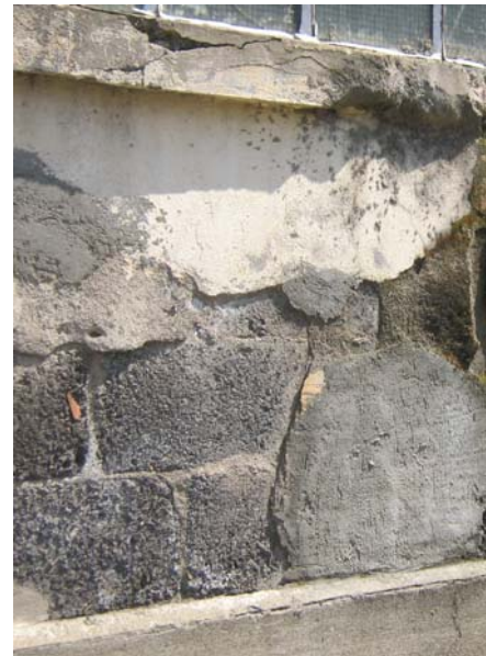
Photo 4.51. Effritement et érosion de l'enduit de ciment. (Source : l'auteur).
