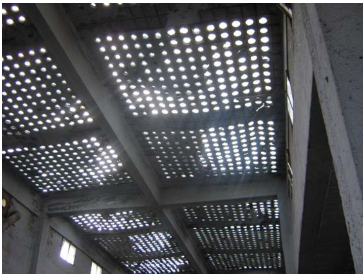
Photo 4.47. Déformation et corrosion de la couverture. (Source : l'auteur).
