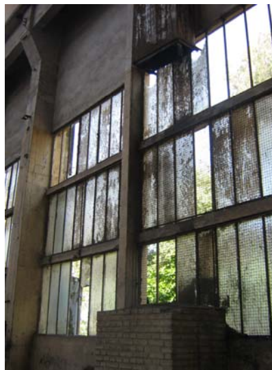
Photo 4.57. Salissure due à l'activité (Fonderie). (Source : l'auteur).
