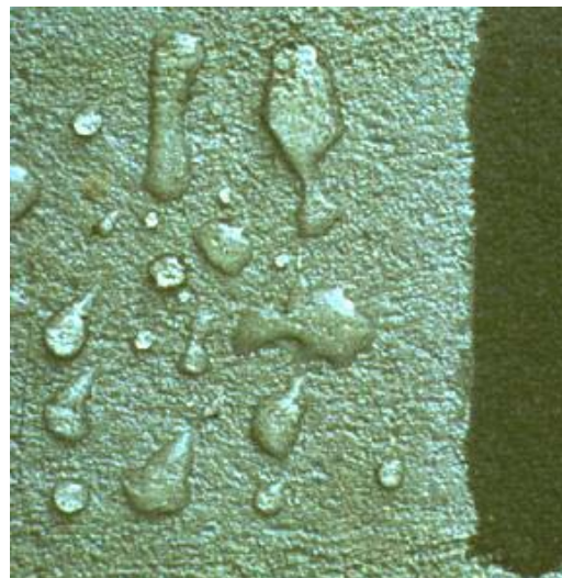
Photo 4.64. Effet des produits hydrofuges sur les murs de façades. (Source : AFGC/CEFRACOR, 2003.)
