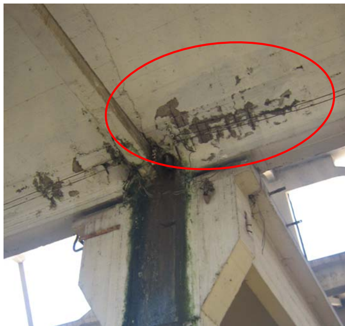
Photo 4.45. Gonflement et érosion de la couverture du bloc A. (Source : l'auteur).
