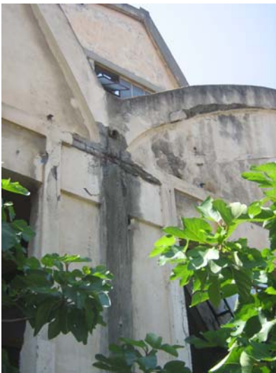
Photo 4.56. Salissure due aux eaux pluviales. (Source : l'auteur).
