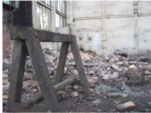
Photo 4.42. Gravas occupant le plancher du bloc B. (Source : l'auteur).
