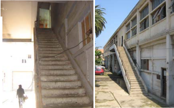
Photo 4.11. Vue sur un des escaliers intérieurs qui mène à l'atelier d'accès. Photo 4.12. Vue sur l'escalier d'accès à l'atelier.
