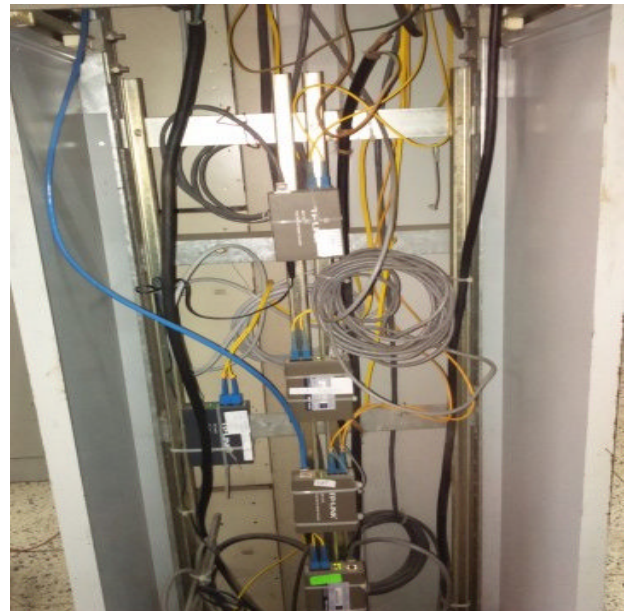
Figure 8 : Raccordement du convertisseur au niveau du CA.
