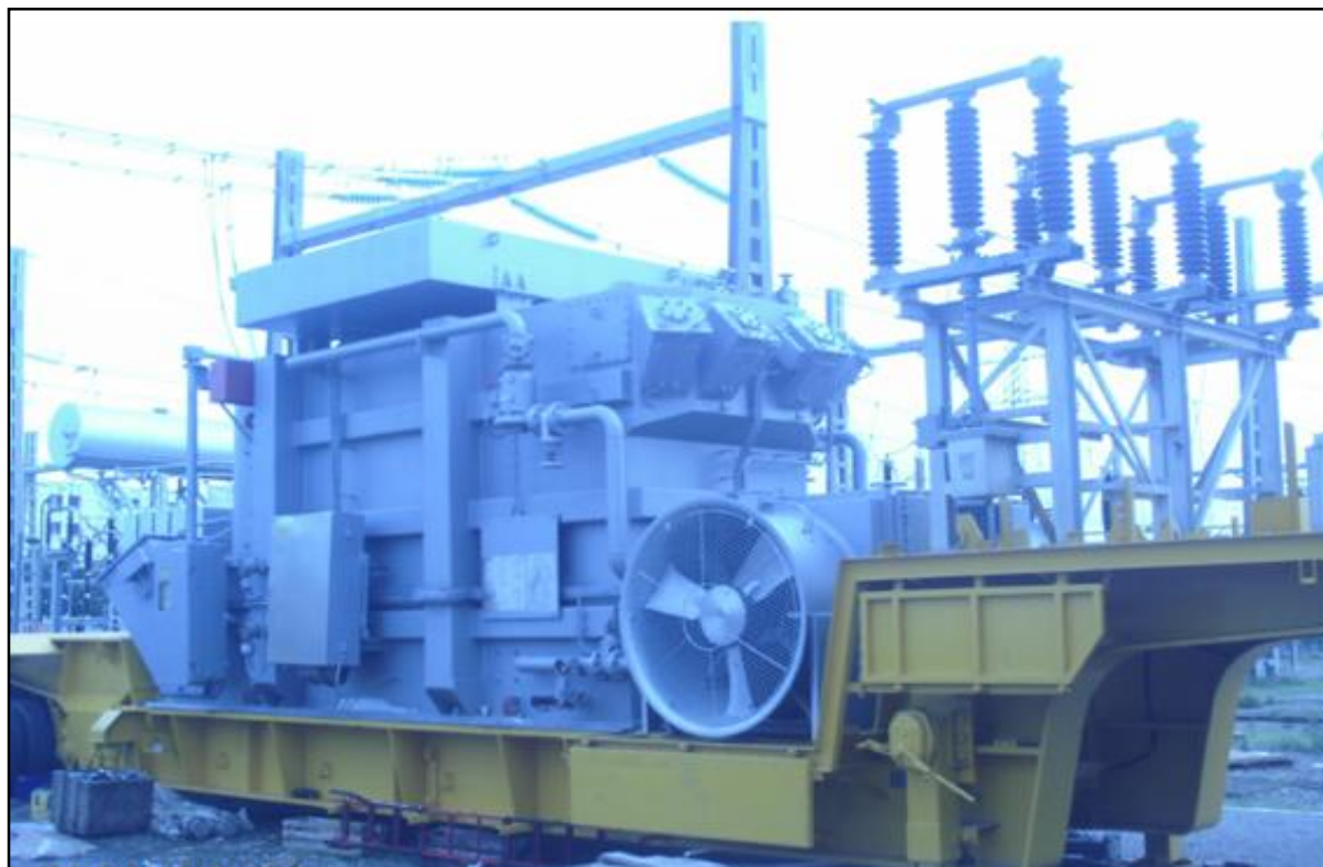
Figure IV.1 : Photographie d'une cabine Mobile 60 /30 kV 20MVA
