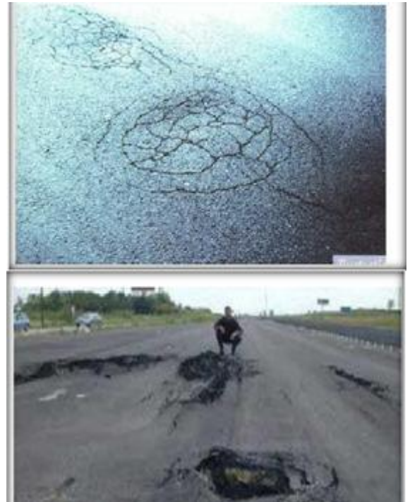
Figure III-3 : Dégradation des routes et des chaussées (Freeah, 2006 et Jennings, 1962).
