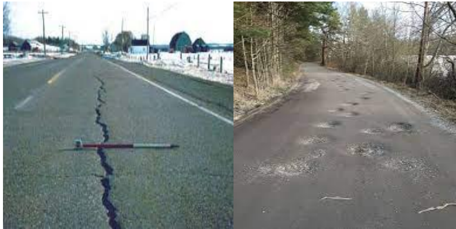
Figure I.21. Désordres de chaussées dues au gonflement
