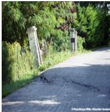
Figure I.24. Route déformée et clôture penchée
