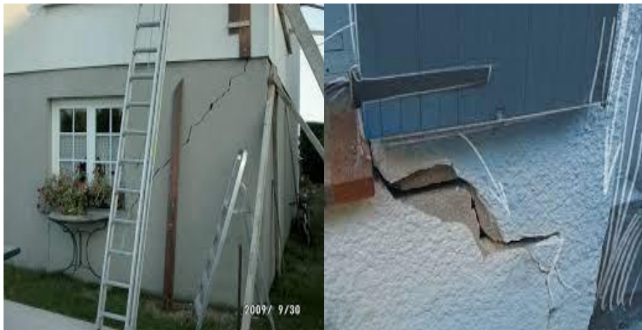
Figure I.20. Fissurations des façades des maisons
