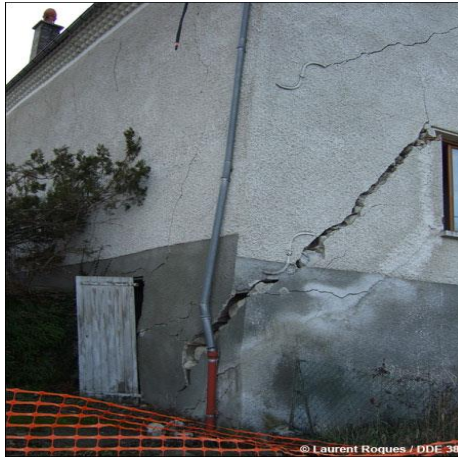
Figure I.23. Fissure profonde sur une maison
