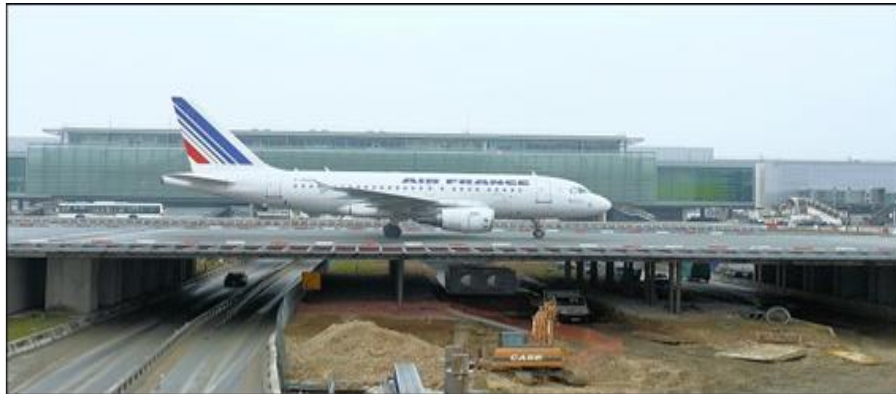
Figure I. 2 : Pont-avion à l'aéroport de Roissy-Charles-de-Gaulle.
