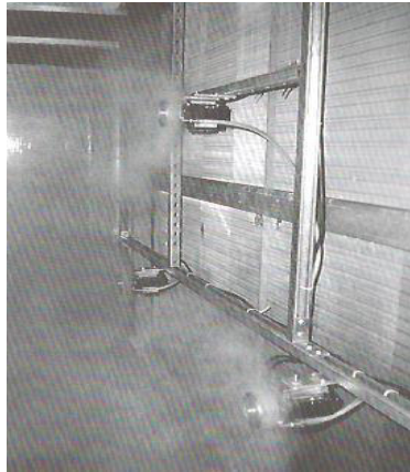
Fig. II- 6: Caisson humidificateur d'une centrale de traitement d'air équipé de trois atomiseurs à buse rotative.
